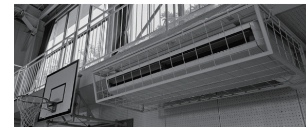
▲体育館のエアコンは複数台設置される
